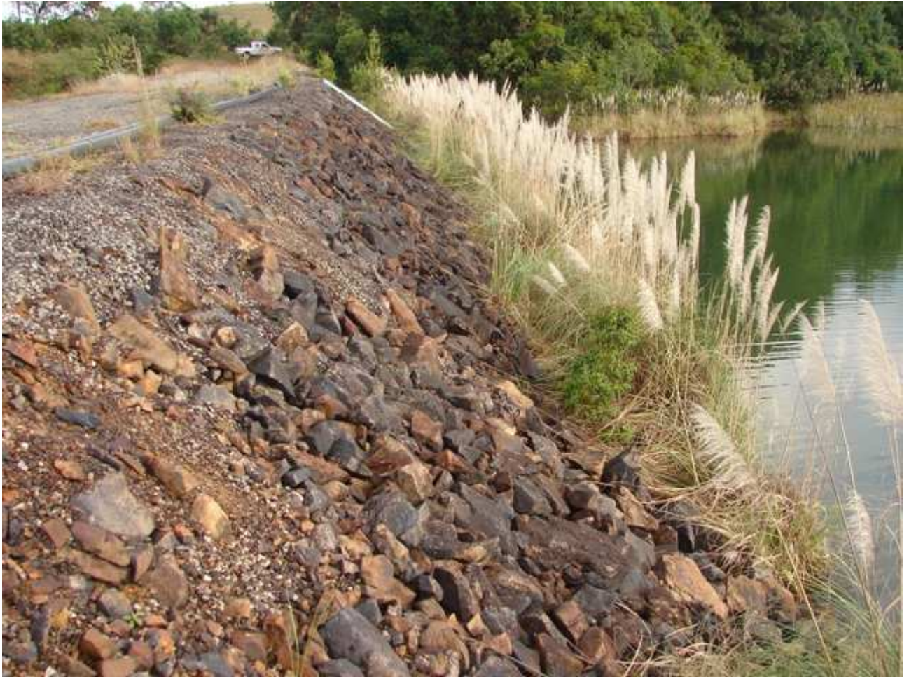
Figura X – Barragem de Rejeito – Borda livre de 1,20m. Dimensionada considerando os recalques totais previstos e a onda máxima para uma velocidade máxima de 70km/h na direção do fetch máximo
