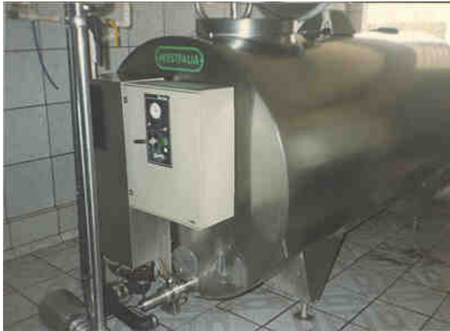
Figura 12 – Foto do tanque de expansão
