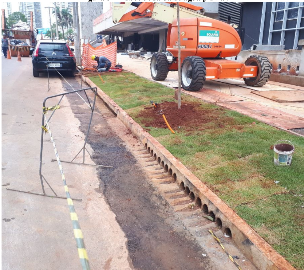
Figura 3 – Tubos de saída de água pluvial.
